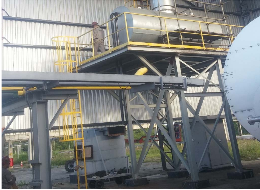
Figura 8: Estrutura do Desaerador
