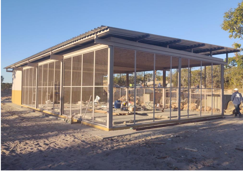
Figura 6: Casa de bombas para 12 motores
