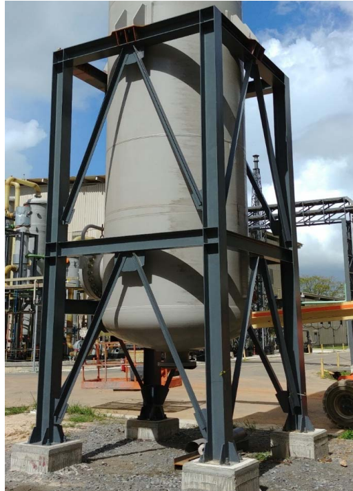
Figura 20: Estrutura apoio do vaso C-4220
