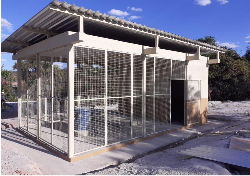
Figura 8: Casa de bombas para 2 motores
