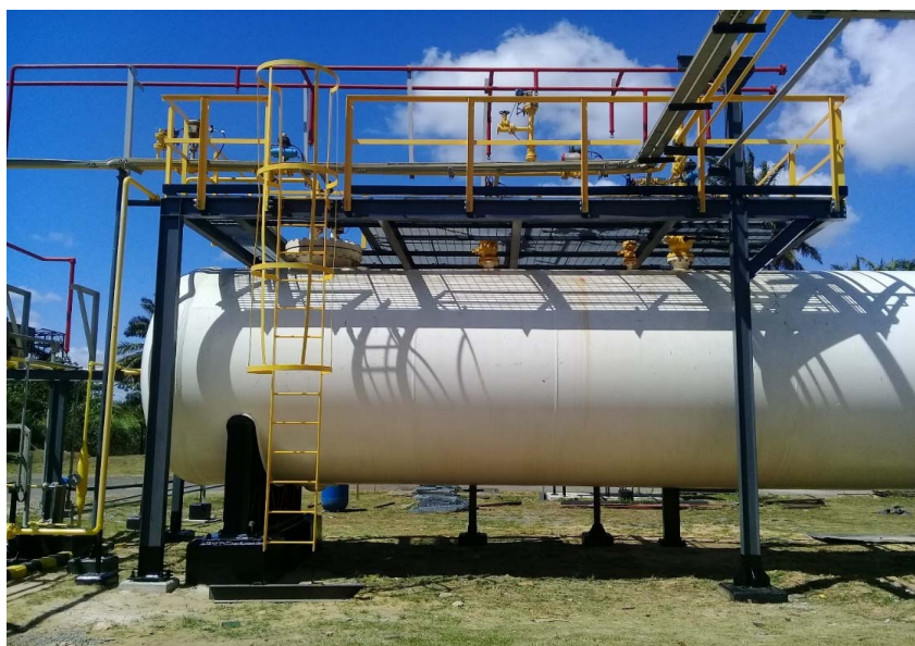
Figura 22: Plataforma sobre tanque
