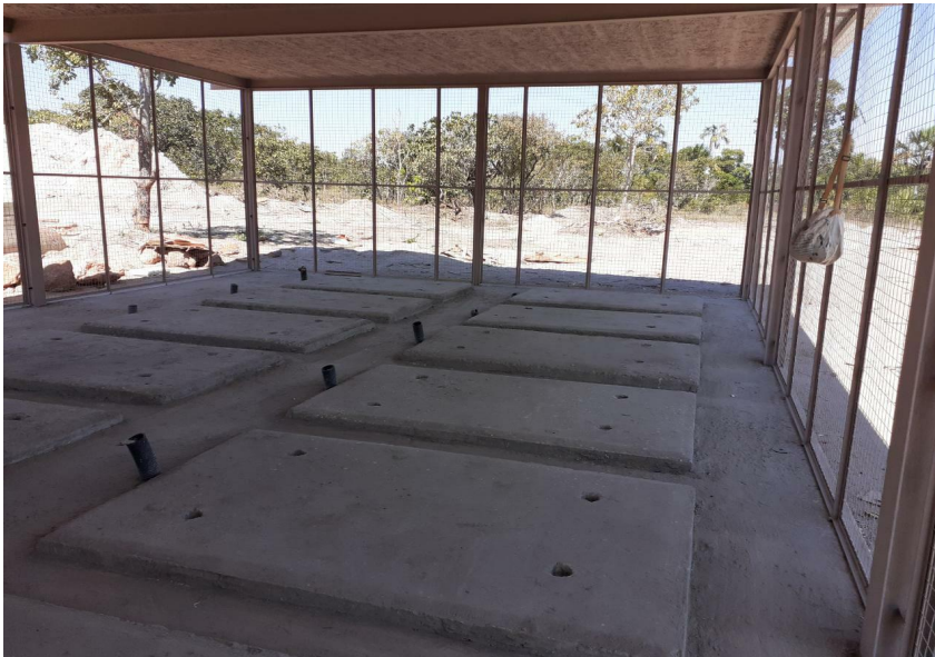
Figura 7: Casa de bombas para 12 motores
